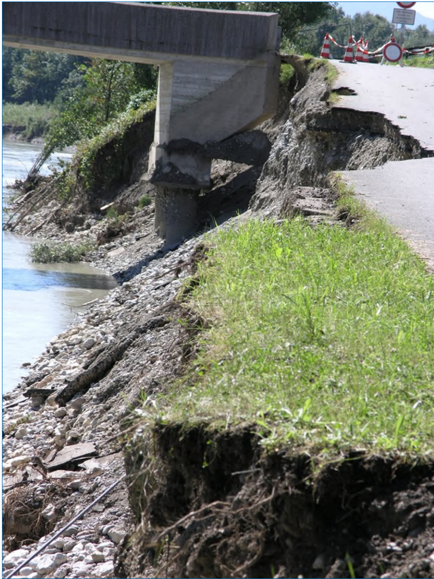
Abb. 4: Uferabbrüche am Zollhaussteg, Gemeinde Oberaudorf (Foto: WWA Rosenheim)
