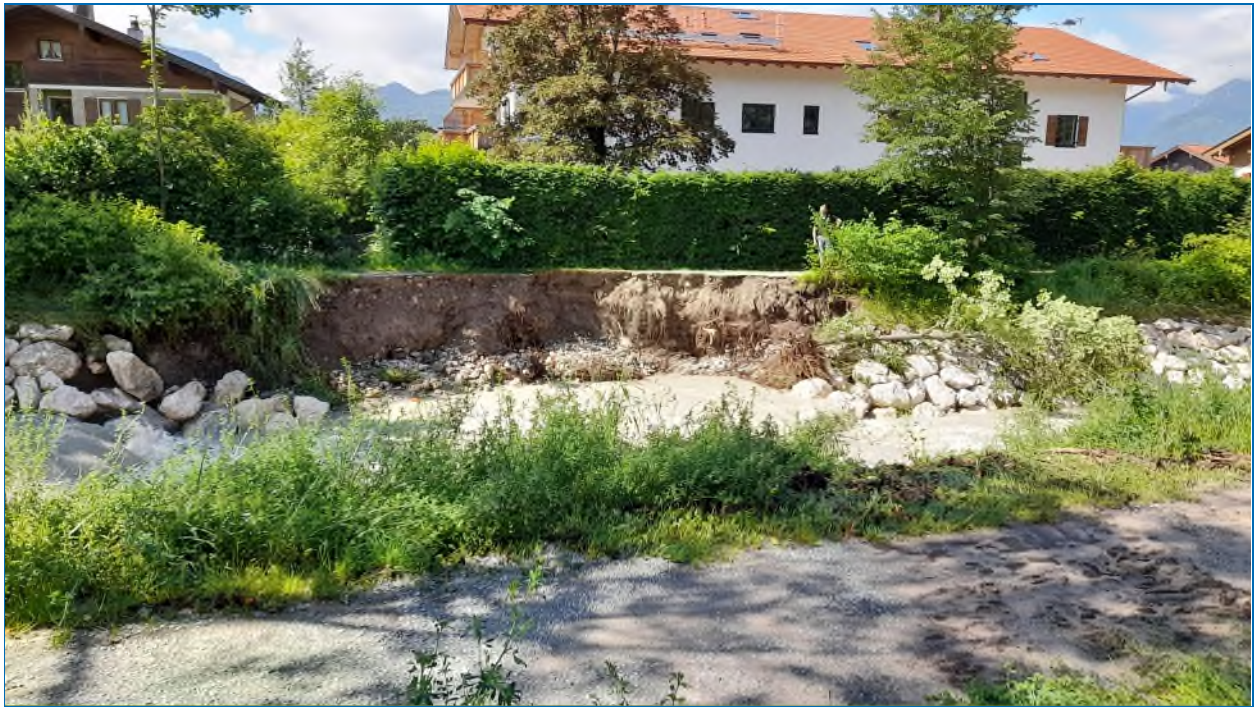
Abb. 54: zerstörte Uferbefestigung am Steinbach ...
