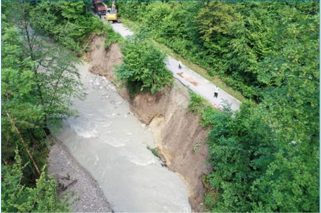
Abb. 48: zerstörte Uferböschung am Steinbach im Mühlal
