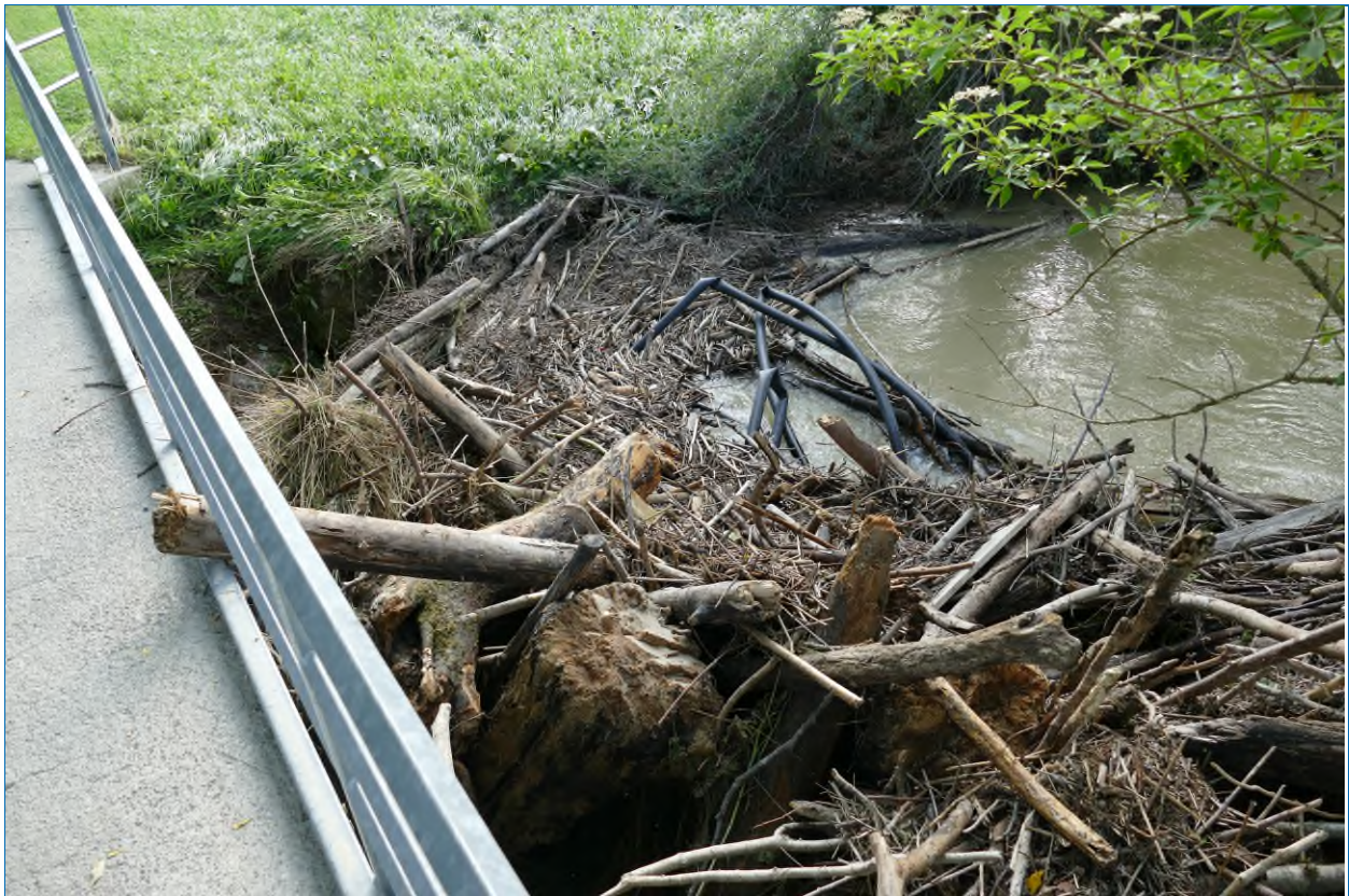
Abb. 70: Verklauung an einer Brücke über den Aubach kurz vor der Mündung in die Kalten (Rosenheim)
