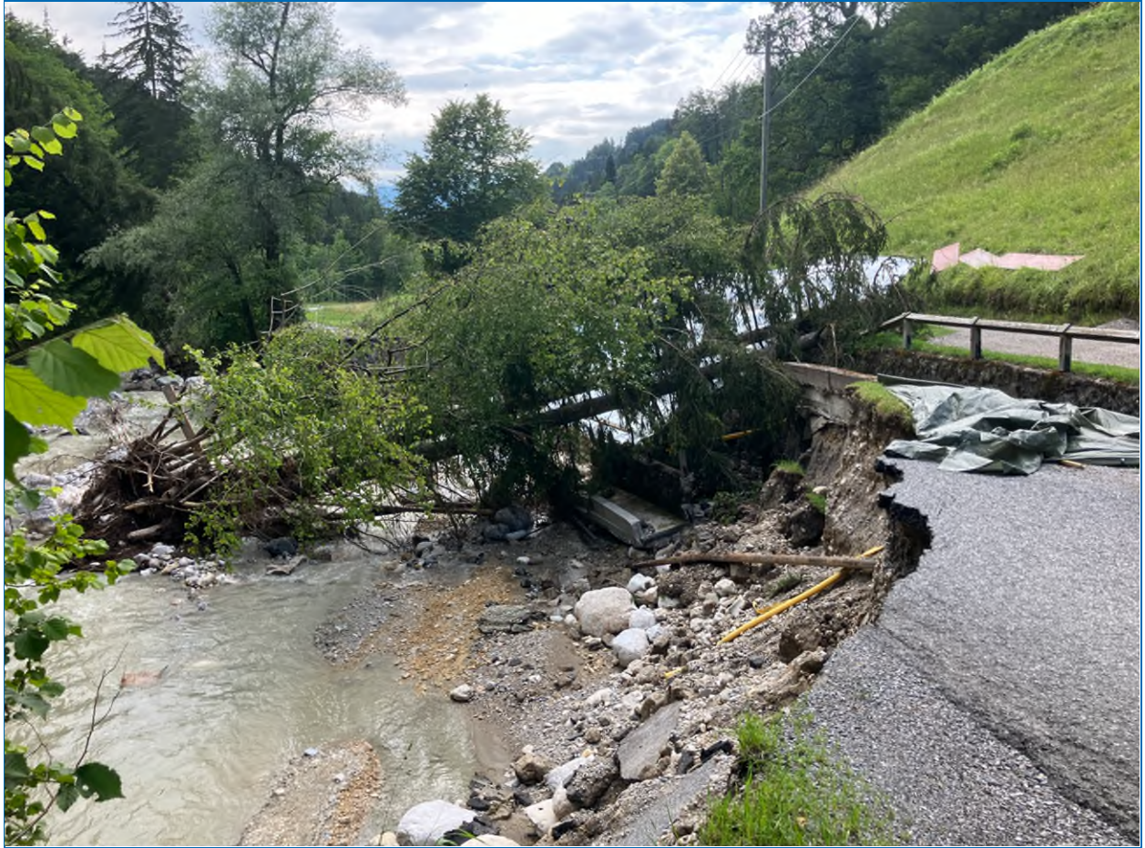
Abb. 45: Ufererosion im oberen Mühlthal, Straße und Zulaufkanal zu einem Triebwerk sind zerstört, Blick von oberstrom – Nußdorf
