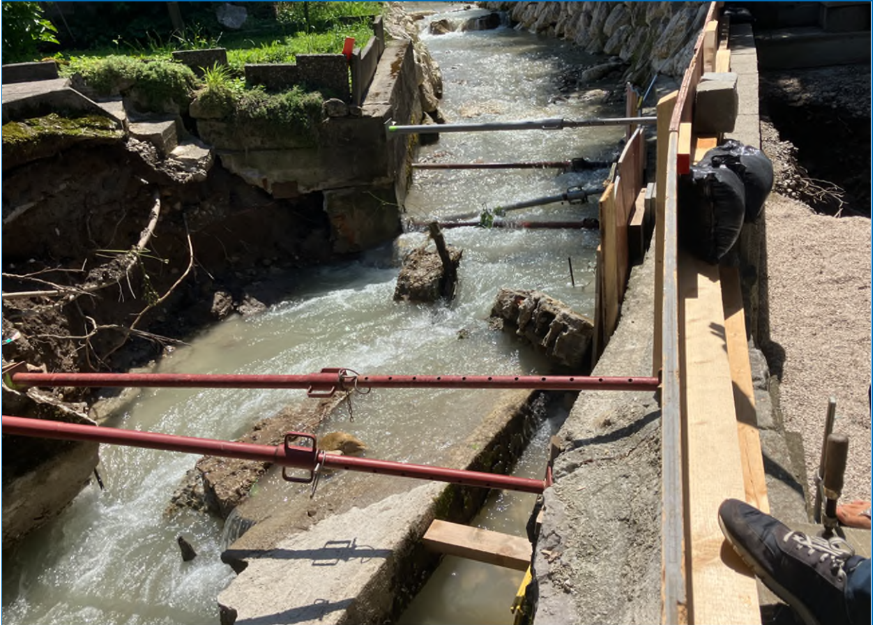
Abb. 65: Vorläufige Sicherungsmaßnahmen am Speckbach in Achenmühle
