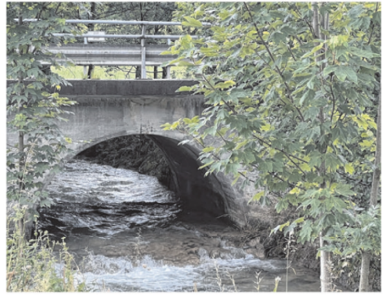
Das Nadelöhr in Achenmühle ist der Durchlass unter der Frasdorfer Straße. Auch ohne Verkläunungen ist er zu eng. Deshalb soll er vergrößert werden. FOTO GERLACH
