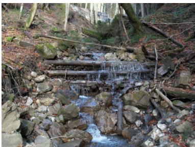
Zerstörte Holzsperresperre am Rißbach
