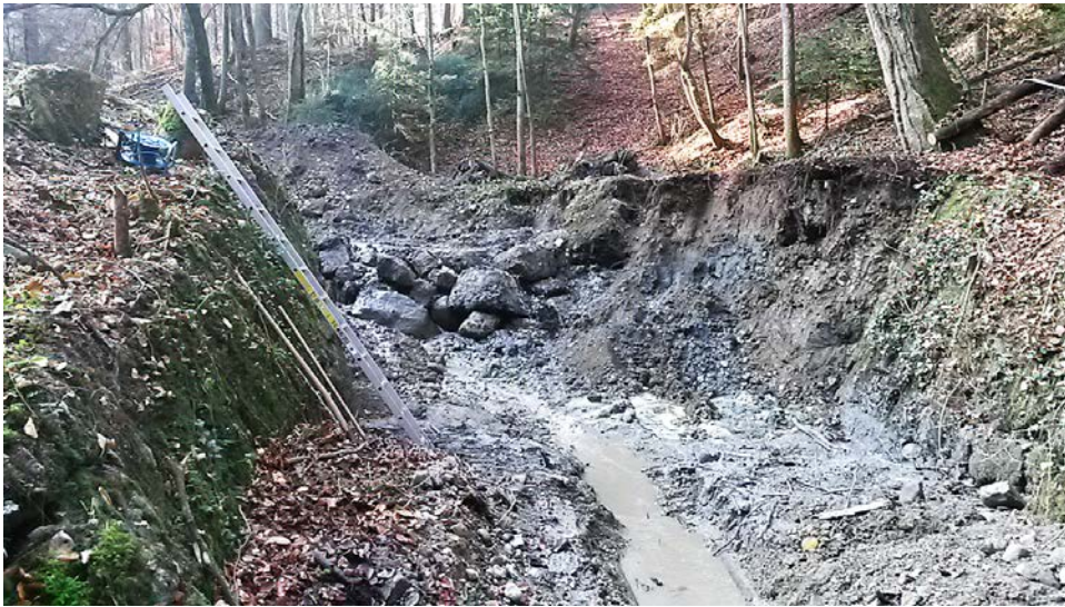
Der rutschgefährdete Hang unterhalb des Schlosses
