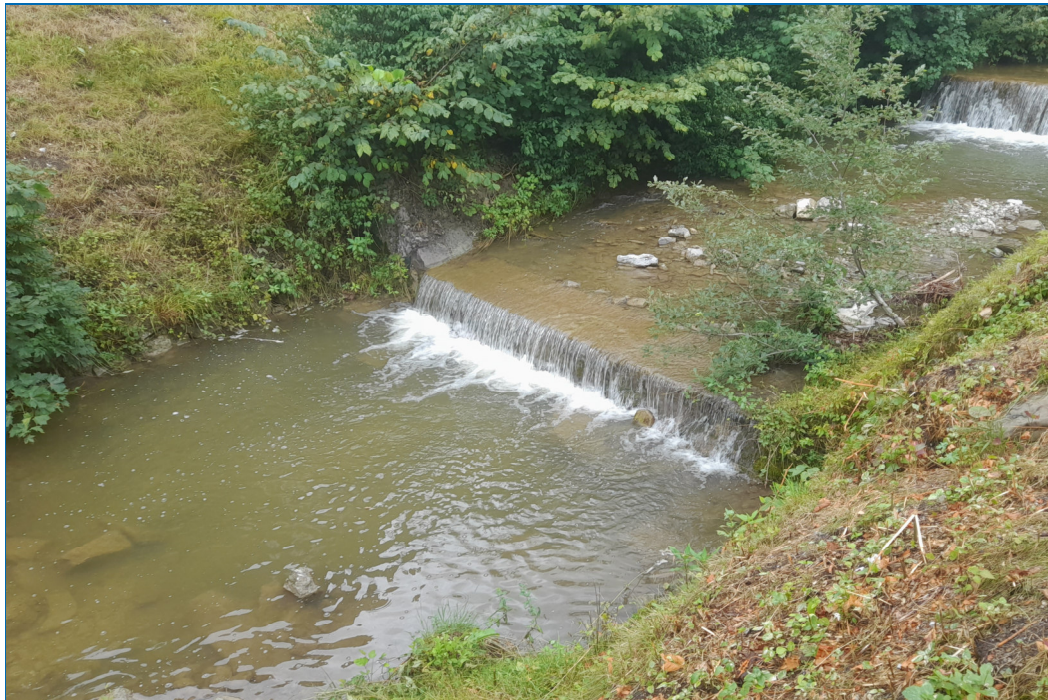
Zerstörte Sohlsicherung unterhalb einer Wildbachsperre
