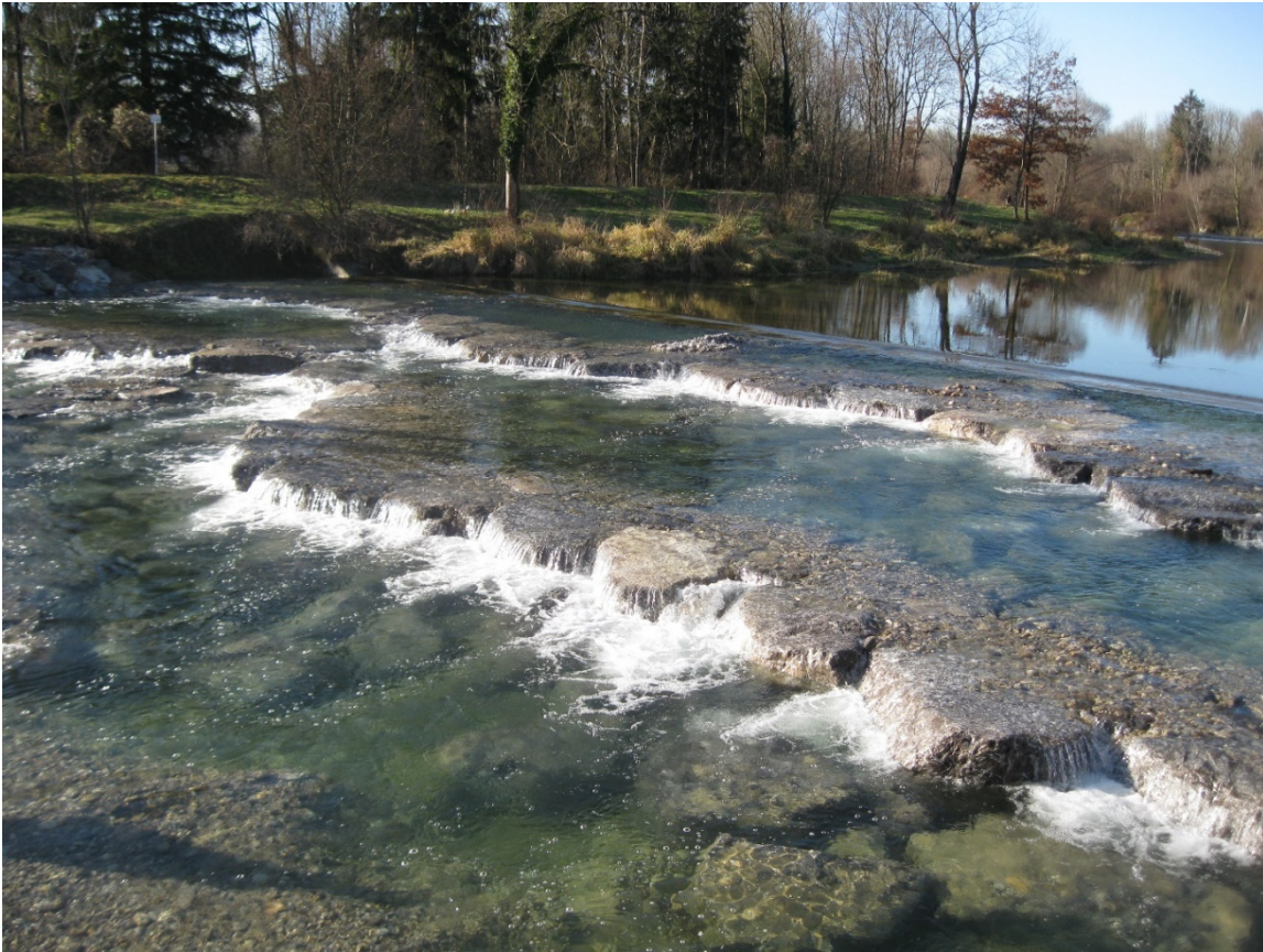
So könnte die umgebaute Sohlrampe nach Fertigstellung aussehen. Hier ein Bild eines bereits umgebauten Absturzes an der Mangfall.
